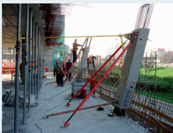
Fig. 3 Site assembly of the prefabricated column of the frontage wall Obr. 3 Montáž prefa sloupu fasádní stěny
